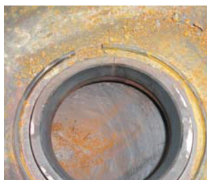
阀座贯穿裂纹
